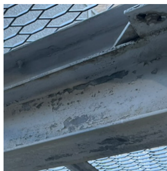
施工前（塗装の剥がれが目立つ状況）
