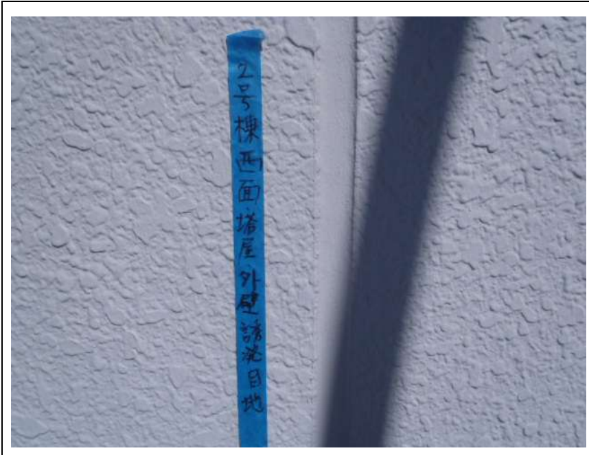
No. 16 2号棟西面屋上塔屋誘発目地
