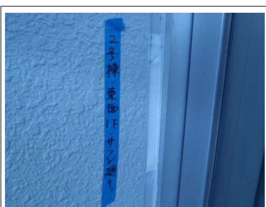
No. 15 2号棟東面1階サッシ廻り目地
