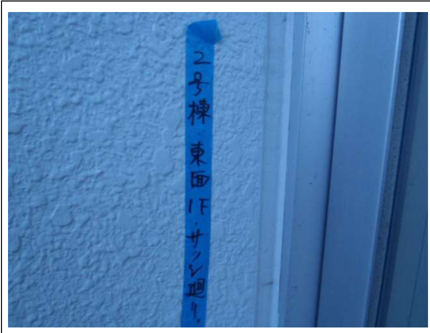
No. 13 2号棟東面1階サッシ廻り目地
