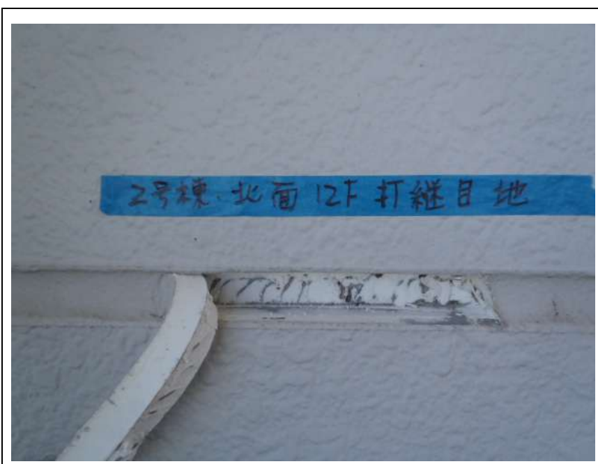
No. 23 2号棟北面2階打継目地 サンプル採取後
