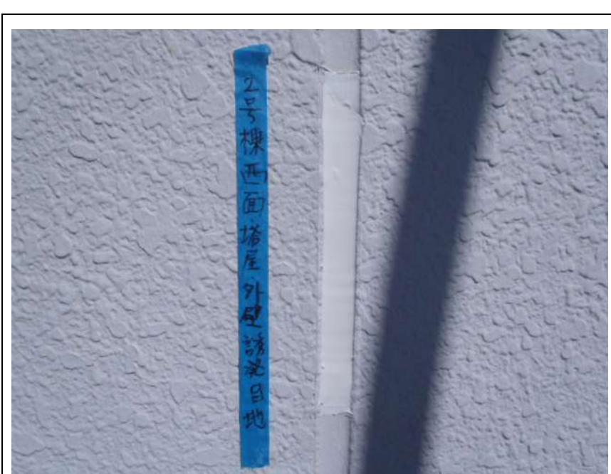
No. 18 2号棟西面屋上塔屋誘発目地
