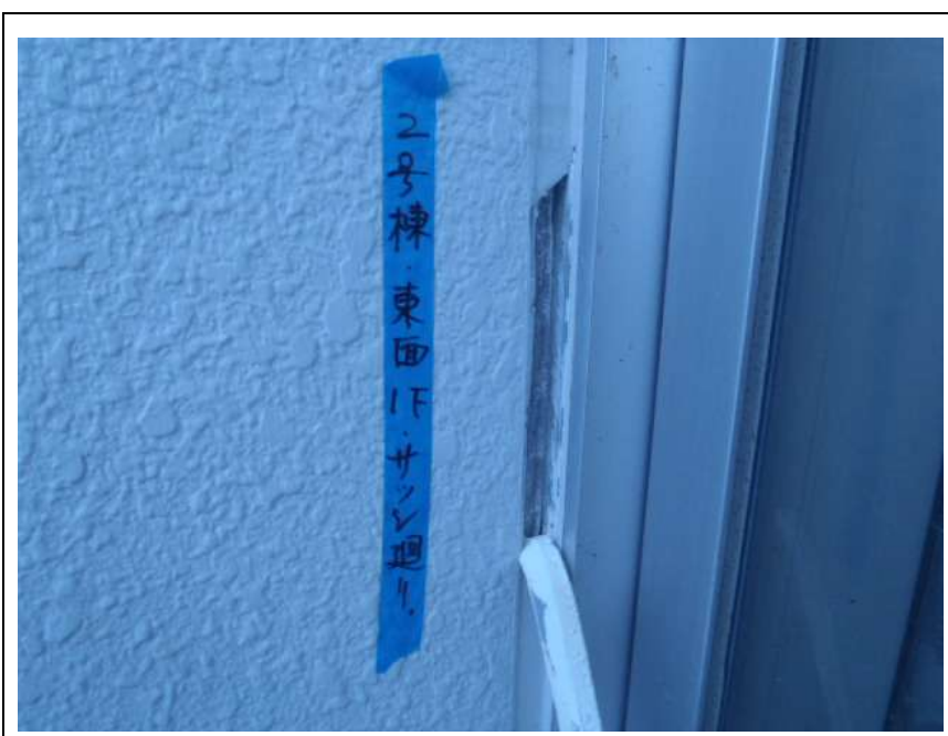
No. 14 2号棟東面1階サッシ廻り目地
