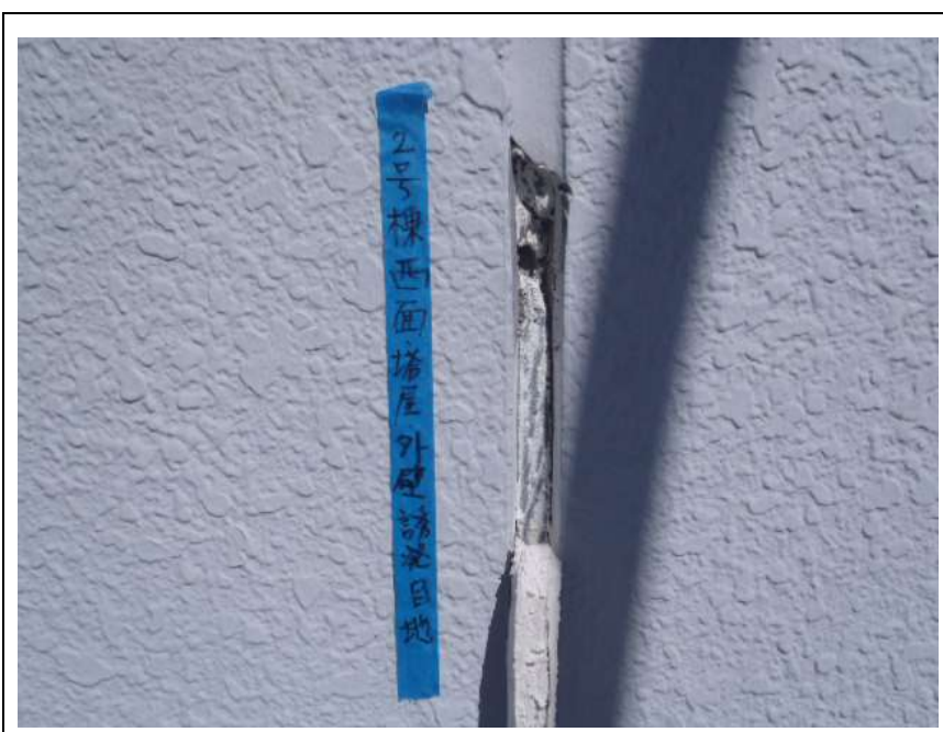
No. 17 2号棟西面屋上塔屋誘発目地
